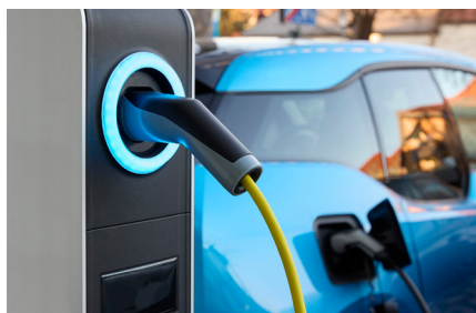
Infrastructure pour VE
